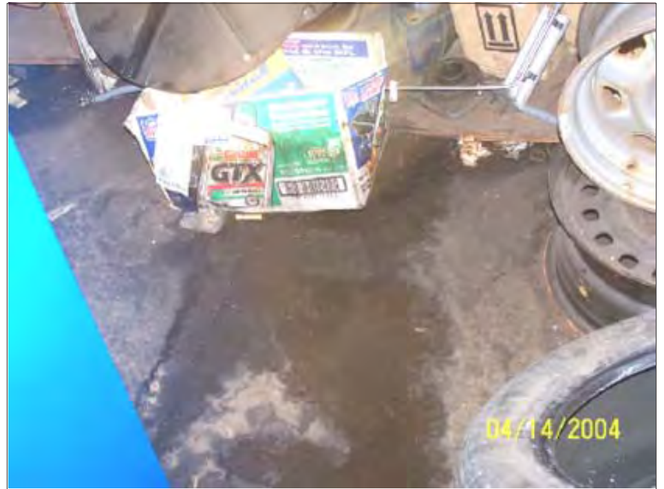
El piso del garaje municipal donde los empleados de la ciudad trabajan, mojado de la lluvia que penetra por el techo.
